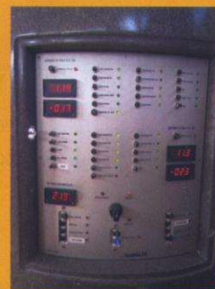
A sinistra, il grande frigo e l'altrettanto grande freezer. Sopra, il quadro elettrico posto sul fianco del carteggio
